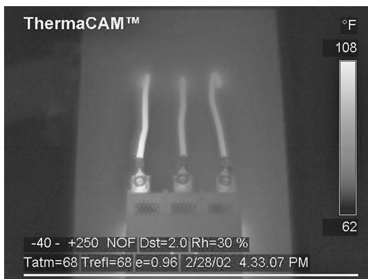
Figure 6.14 – Échauffement anormal résultant d'un défaut de serrage de bornes sur un contacteur de lignes.
