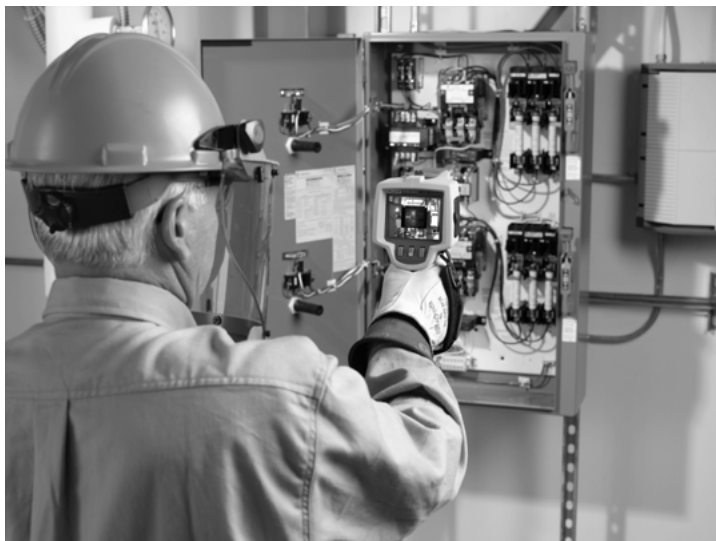
Figure 6.21 – Utilisation d'une TI 10 pour contrôle de points chauds.
