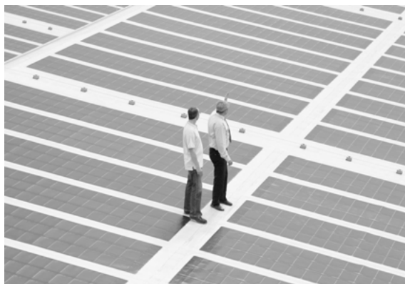
Figure 8.17 – La toiture photovoltaïque du site de production de Sankt Ingbert (Groupe Festo).
