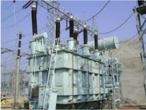
Figure 18 : Poste de transformation Haute Tension
