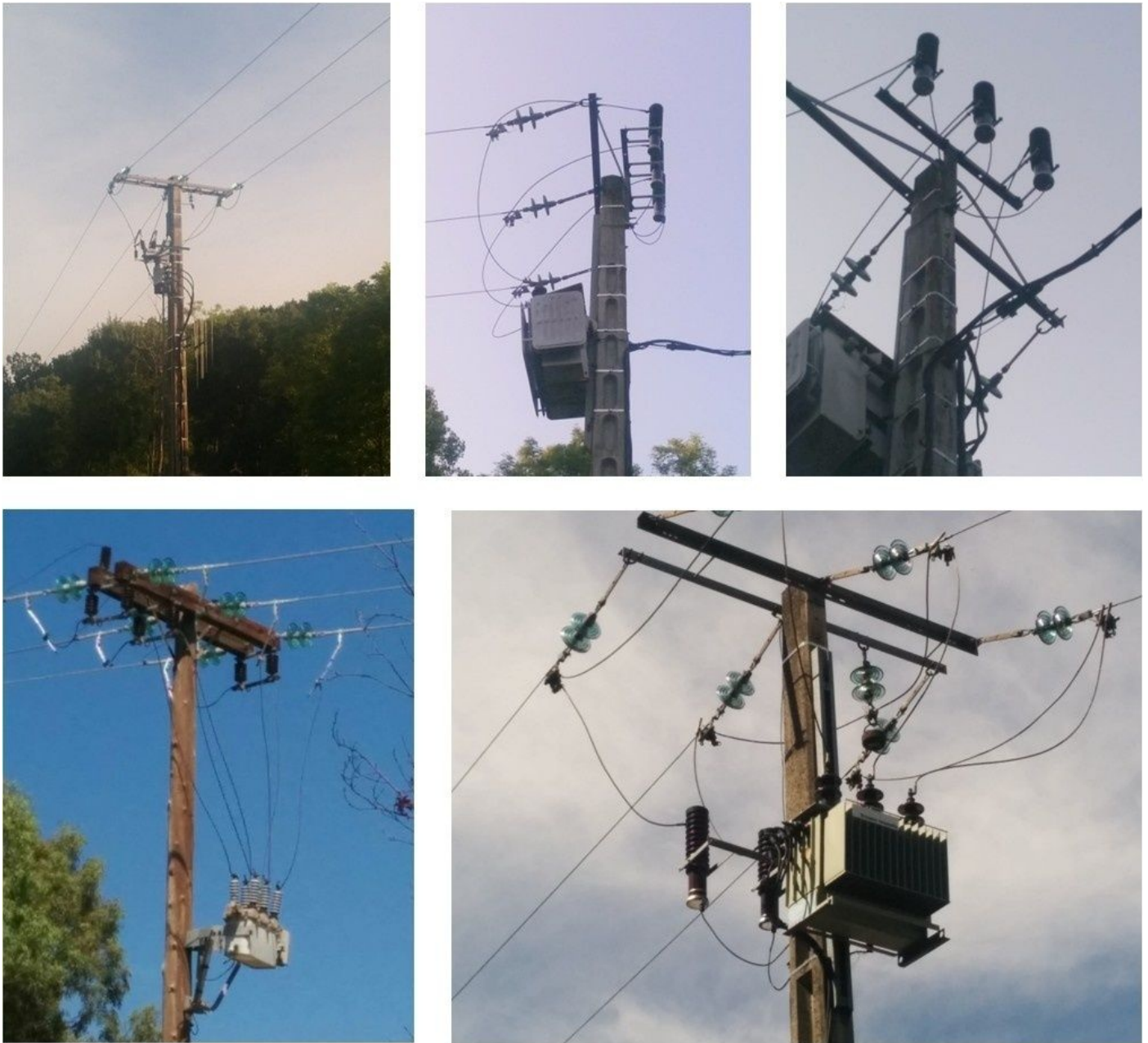
Figure 20 : Transformateurs abaisseurs desservant des villages.
