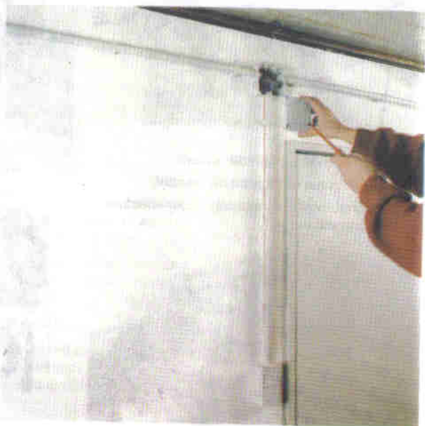
15. L'installation est terminée. La première mise sous tension peut se faire. Attention, lors de la première mise sous tension, il y a risque de court-circuit si le montage comporte une erreur de câblage.
