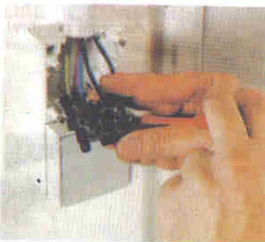
12. Connexion d'un interrupteur.
